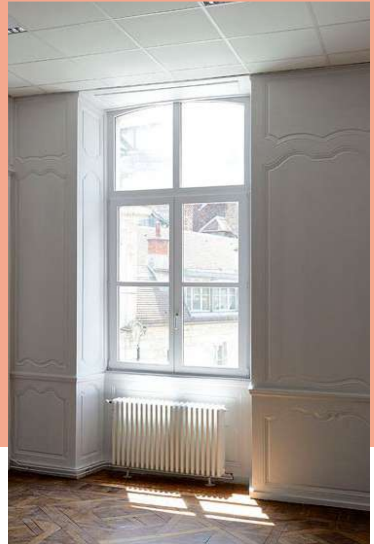
Radiateurs intégrés – 6, rue de la Madeleine à Besançon (25) © Nicolas Waltefaugle Architectes : Lefranc-Corbet-Friant et Tempesta
