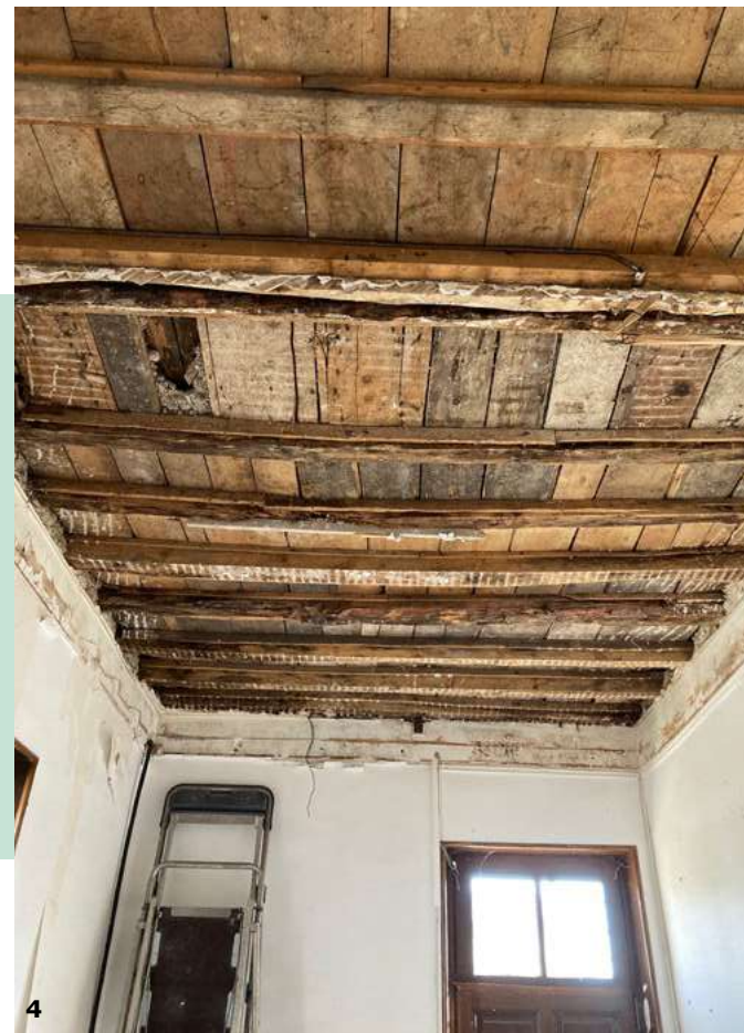
4. Plancher présentant une flèche importante et le pourrissement des solives © Stéphanie Honnert Architecte
