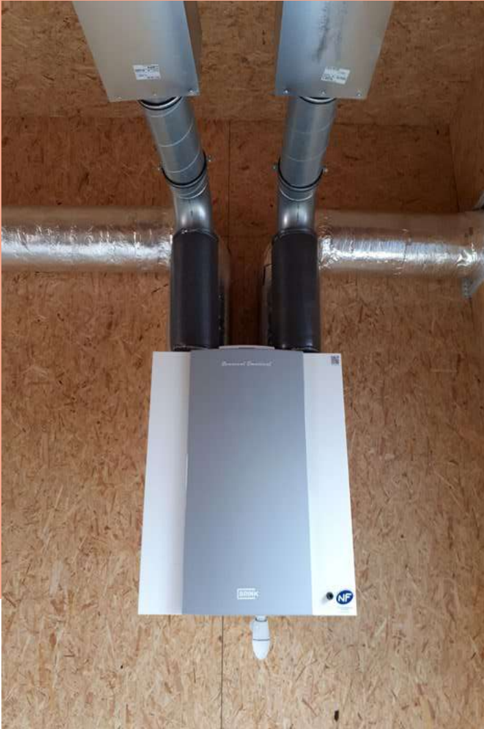
Système de ventilation dans un logement © AQC
