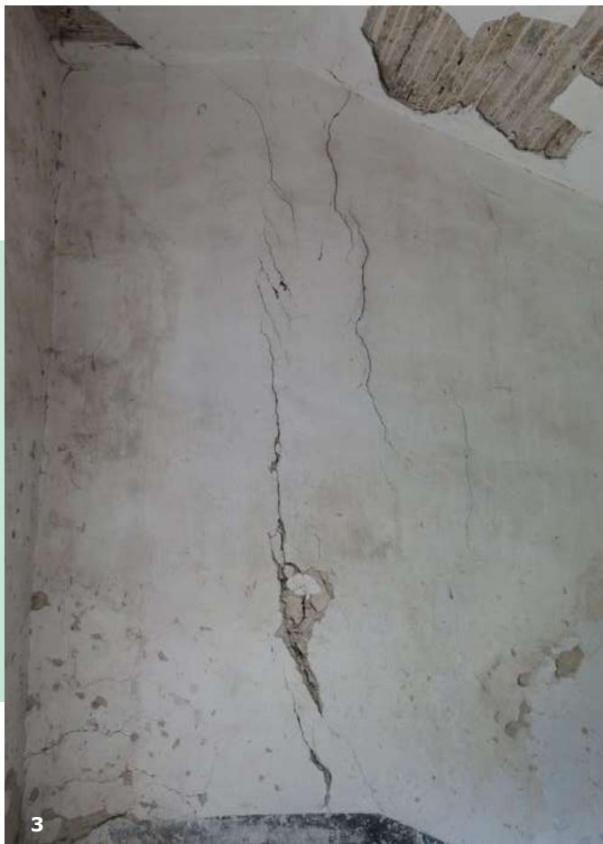
3. Infiltrations ayant entraîné la décohésion des maçonneries, fissurations résultant du gonflement du parement maçonné © Stéphanie Honnert Architecte
