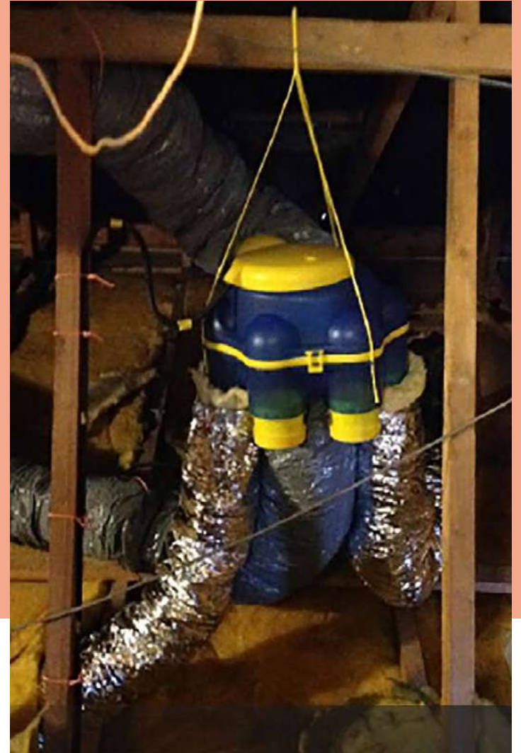
VMC simple flux installée dans des combles perdus © AQC
