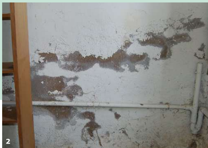
1. Salpêtre – Assé-le-Riboul © CREBA
