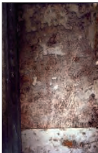
Fig. 6 – Paris, Opéra, côté rue Auber. Altération du calcaire rouge. (Cliché A. Blanc)
