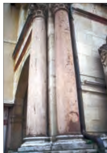
Fig. 20 – Façade de l'Hôtel de ville de Gray. La colonne de gauche présente une fissuration sur toute sa longueur. La base de la colonne de droite, siège des remontées capillaires et d'une forte altération, a fait l'objet d'un ragréage par addition de mortier. (Cliché J.-P. Sizun)
